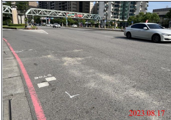
巡查日期地點：112.08.17/ Y23車站 照片說明：路面龜裂狀況
